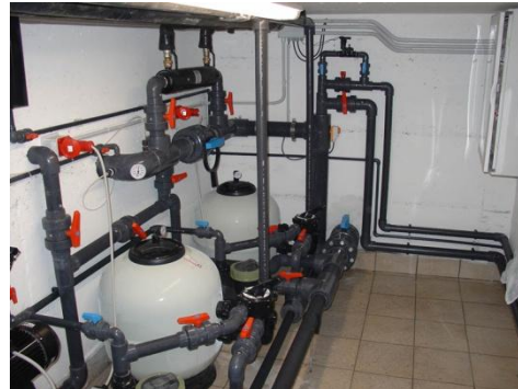
Sistemi di filtraggio
